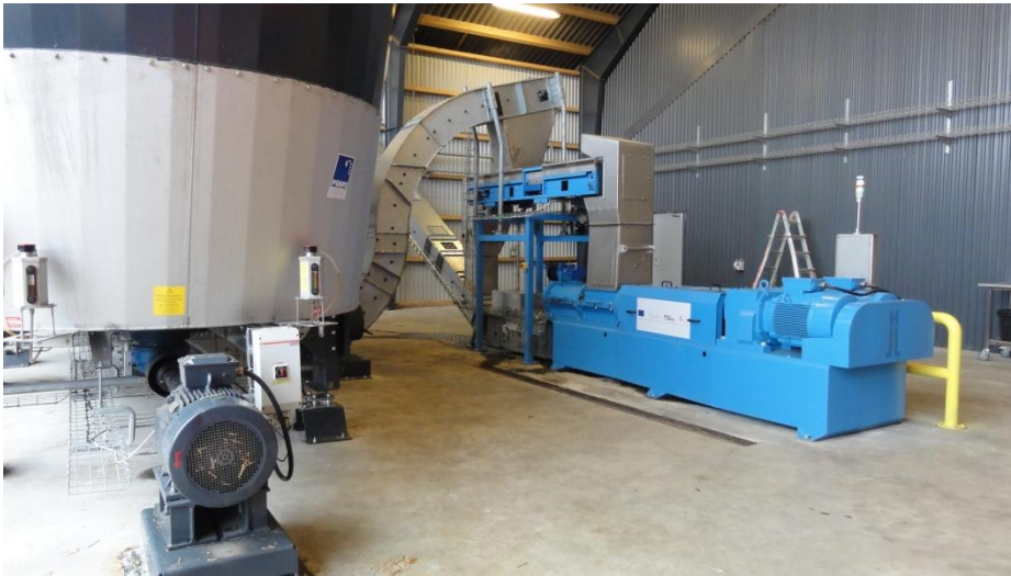
BIOMIXEREN TIL VENSTRE FØDER AUTOMATISK DEN OPREVNE BIOMASSE IND I EKSTRUDEREN, HVORFRA DET FØRES VIDERE TIL FORGÆRDINGSTANKEN.
